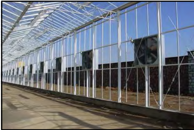
شکل ۱- پنکه‌های دیواری به منظور تهویه هوا
