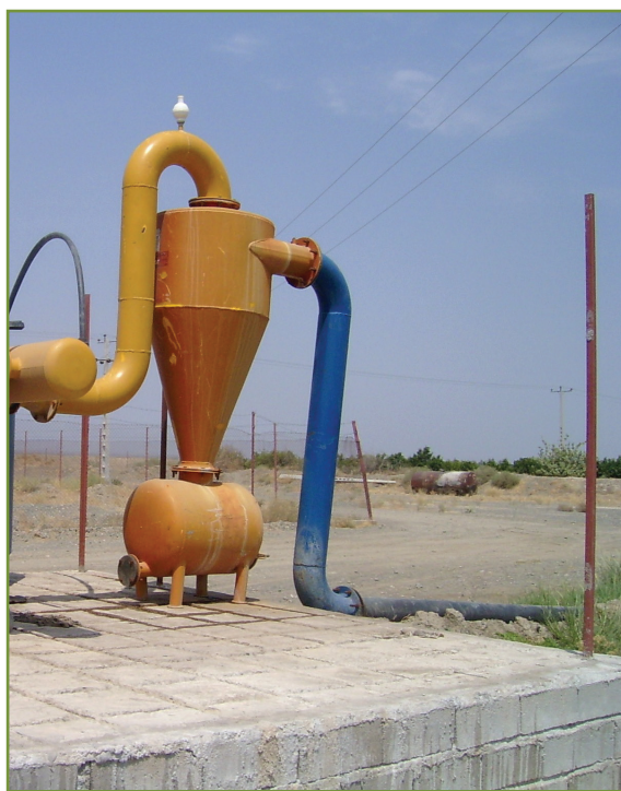
شکل ۸- استفاده از هیدروسیکلون در ایستگاه پمپاژ
