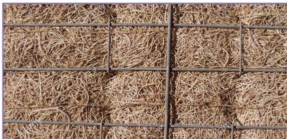
شکل ۳۶- پوشال سوزنی نصب شده در دیواره گلخانه
