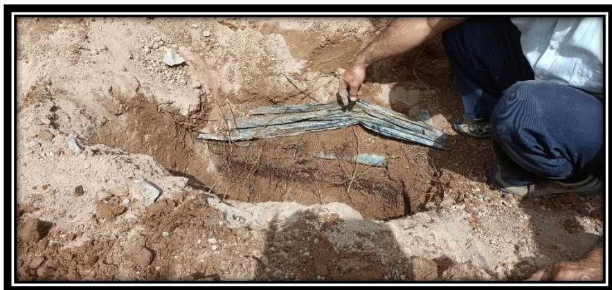
تصویر ۲۵- تجمع ریشه در اطراف لوله آبدۀ در منطقه انار (پایلوٹ ۱۰ ساله روی درختان مسن)
