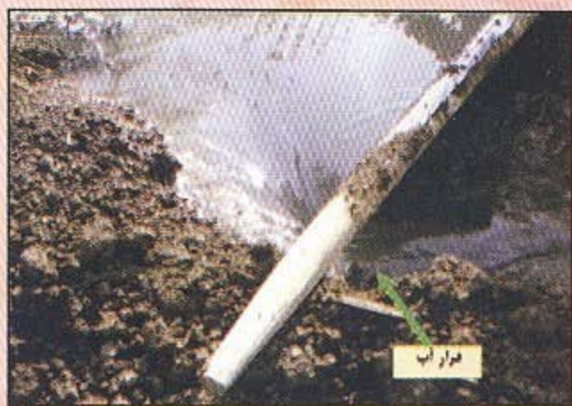
شکل ۷- فرار آب در اثر شکستگی و شسته شدن دیواره نهر در کنار آب‌بند
