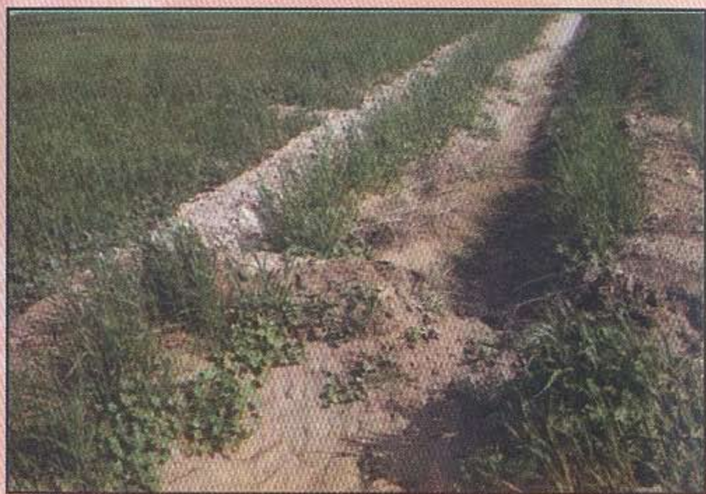
شکل ۲- تخریب دیواره نهر و رسوب گل در آببند خاکی سنتی
