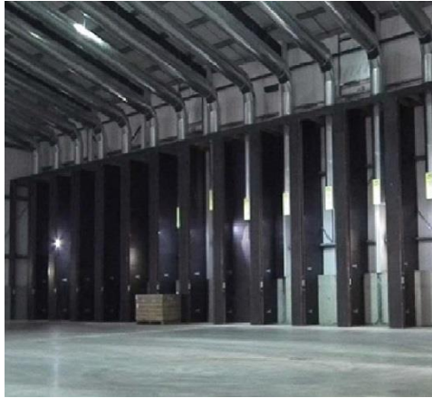
شکل ۳۷- سامانه گرمکن مکشی
