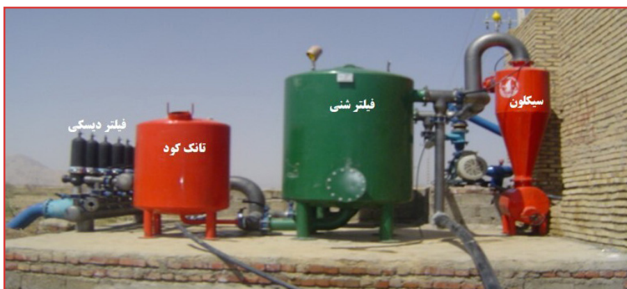
شکل ۳- نمایی از ایستگاه کنترل مرکزی
