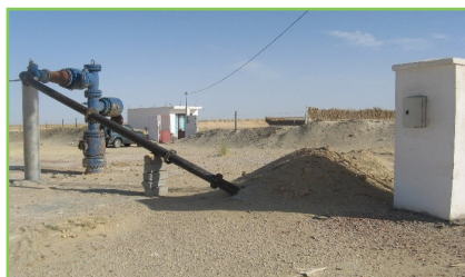
لوله استخراج آب داغ از اعماق زمین
