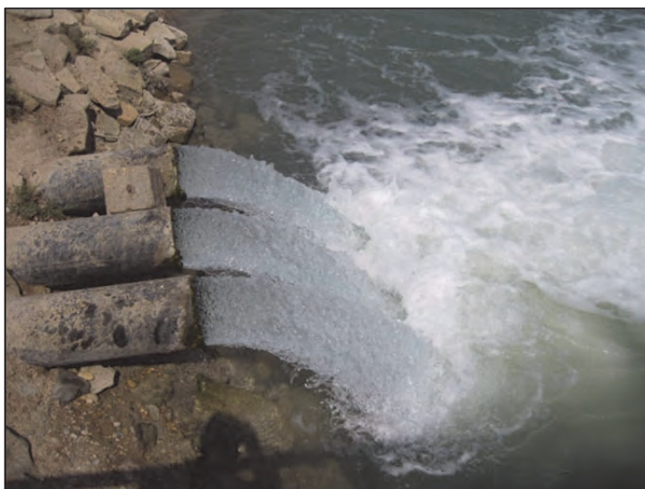
شکل ۱۷- لوله‌های تخلیه کننده زه‌آب در انتهای مسیر یک واحد ایستگاه پمپاژ داخلی در کشت و صنعت نیشکر
