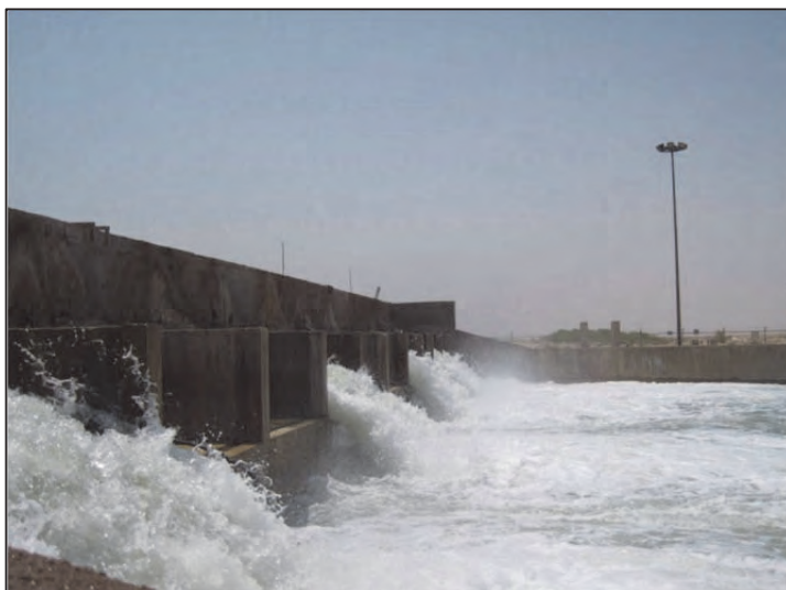
شکل ۱۹- ایستگاه پمپاژ زه‌آب المهدی (مربوط به واحدهای شرقی کشت و صنعت) با ظرفیت ۳۰ مترمکعب در ثانیه
