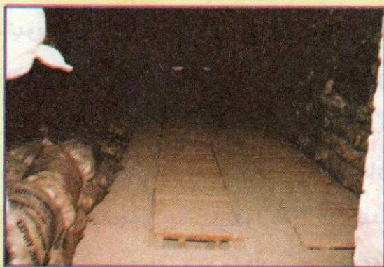
کانالهای تهویه هوا در کف انبار
