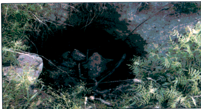
شکل ۷- تخریب میله قنات
