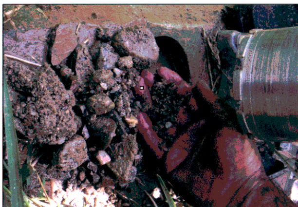
شکل ۴- ازهم پاشیدگی بتن با سنگ دانه‌های ناهمگن
